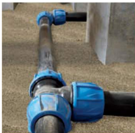
Conduites de distribution d'eau
