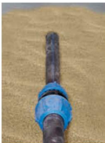
Raccordements aux bâtiments
